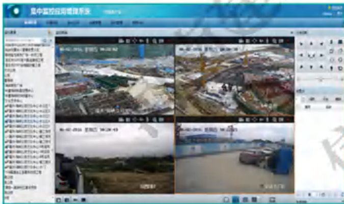
施工现场视频监控系统
