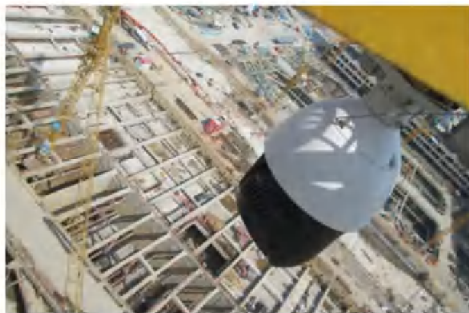
塔机吊钩可视化
