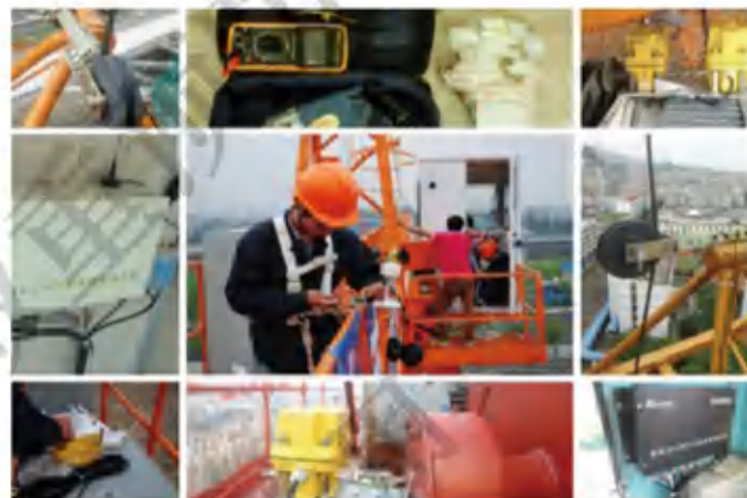
塔吊防碰撞监控系统
